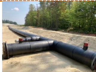
Photo : conduite principale de captage des biogaz
