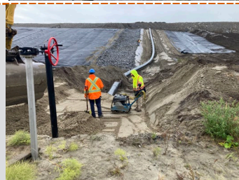
Photo : conduite principale de captage des biogaz
